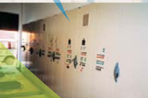
Diferentes cuadros de control de motores, redes de cableado e iluminación
