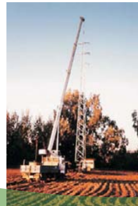
Línea de alta tensión y centro de transformación prefabricado compacto y red aérea de baja tensión.
