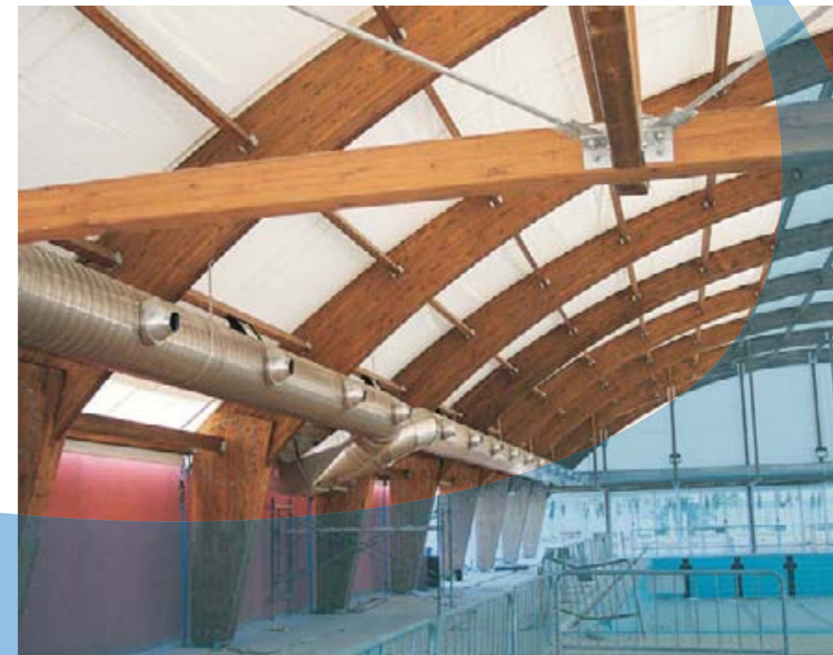
Piscina cubierta climatizada
