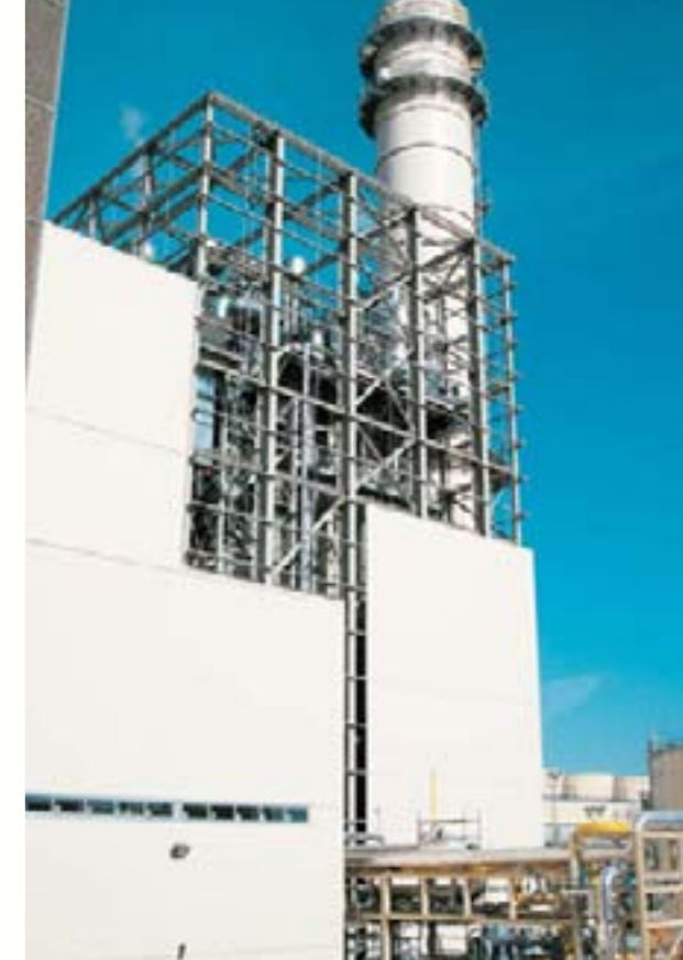
Central de ciclo combinado de Arcos de la Frontera (Cádiz)
