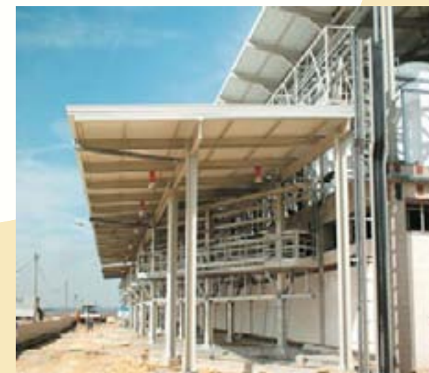
Instalaciones de Brenntag Química
