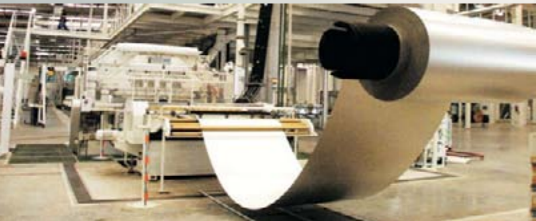
Instalaciones para fábrica de envases metálicos de la multinacional CROWN CORK & SEAL, consistentes en centro de transformación interior, instalación en Baja Tensión, sistemas de voz y datos, sistema de vigilancia y seguridad mediante CCTV, así como alumbrado de parking y zonas exteriores.
