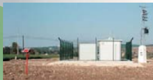
Centro de transformación para oleoducto
