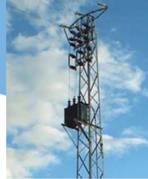
Línea de alta tensión y centro de transformación intemperie
