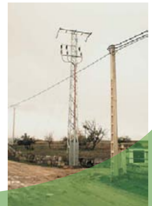
Derivación de Línea de Alta Tensión y Alimentación a Centro de Transformación.
